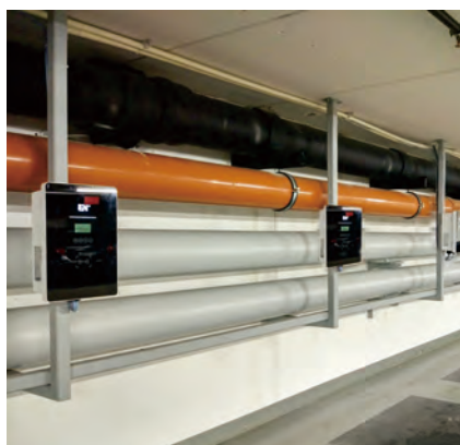
三相交流桩---挪威地下停车场
