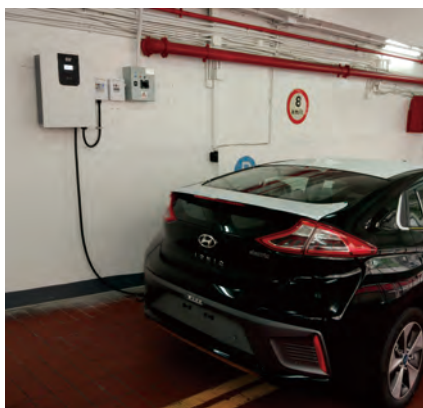
壁挂直流桩---地下车库
