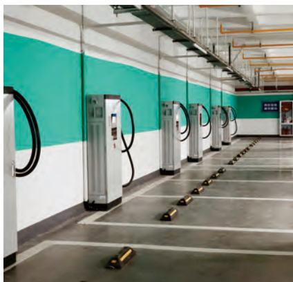
一体直流桩---公共充电站
