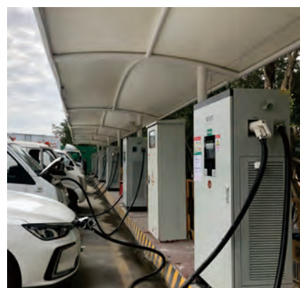
一体式直流桩---公交车充电站
