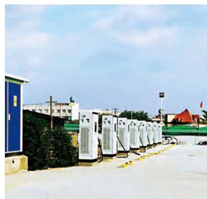
一体式直流桩---公交车充电站
