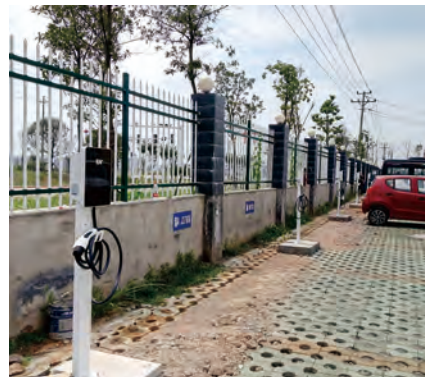
单相交流桩---公共停车场
