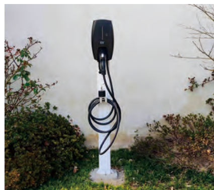
家用交流桩---小区停车场
