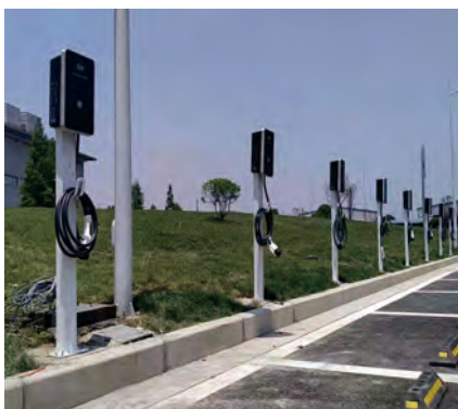
单相交流桩---商业停车场
