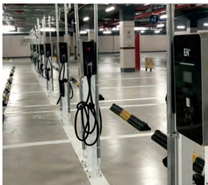
单相交流桩---小区停车场
