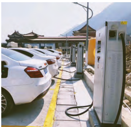
一体直流桩---公共充电站
