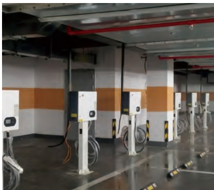
小型直流桩---商业地下停车场
